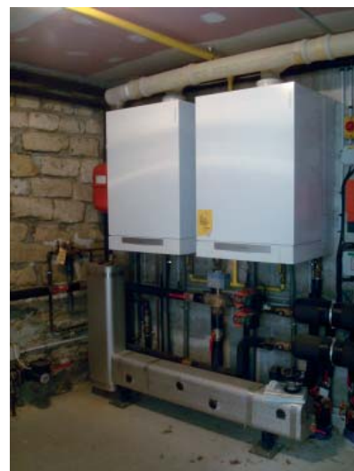
Vue sur la chaudière.
